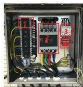
b) 光伏交流汇流箱内部
