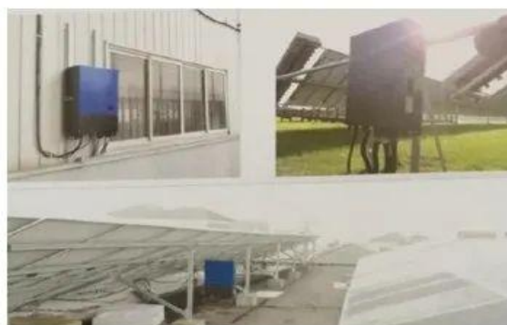
图2-24 组串式逆变器应用现场
