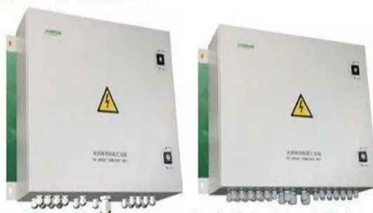
a) 光伏直流汇流箱八进一出
